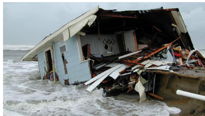
Domages provoqués par une onde de tempête
